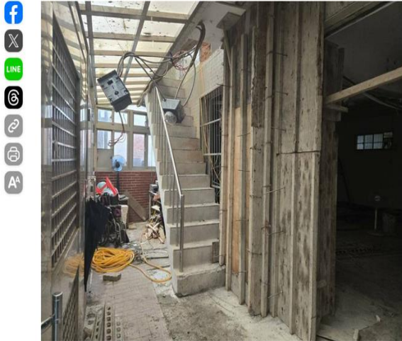
吳姓工人從樓梯跌落頭部著地，傷重不治身亡。(記者吳昇儒翻攝)
